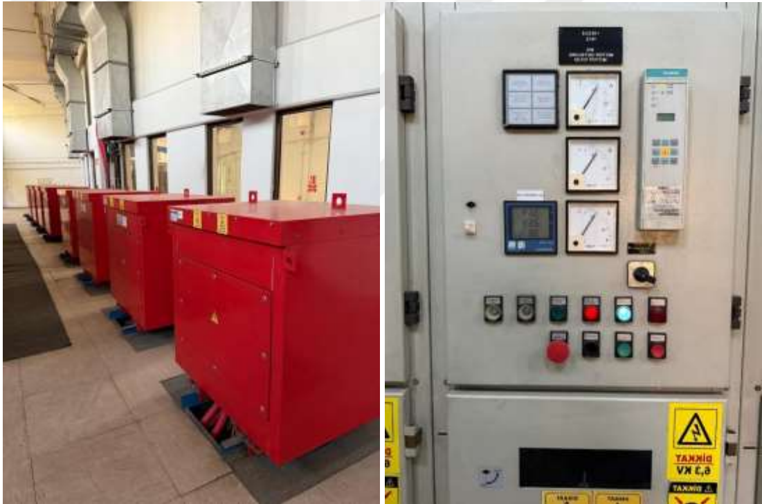
Şekil 3.15: 6.3 kV Beslemeli Oto Transformatör ve Besleme Panosu
