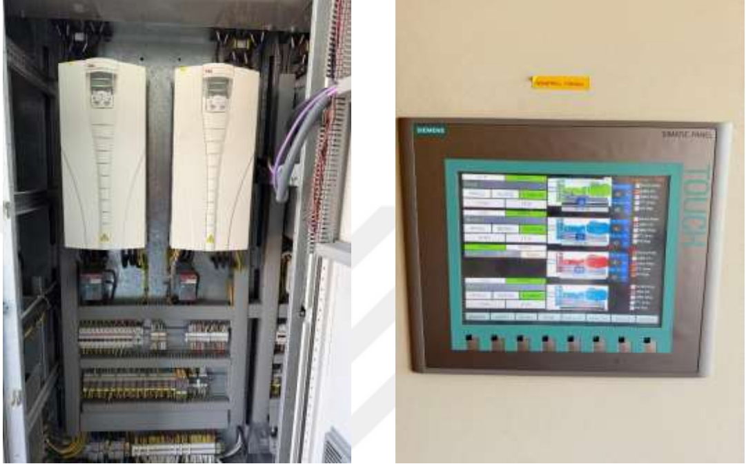
Şekil 3.14: Frekans Konvertörü ve Touch Panel Kontrol Ekranı
