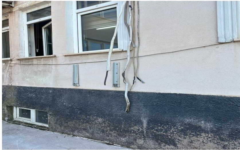
Şekil 3.4: Klima kablolarının açıkta bırakılmasına ait tehlikeli durum örneği
