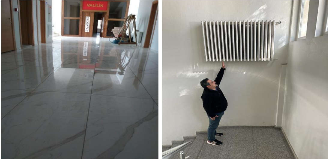
Şekil 3.5: Kaygan zemin ve hatalı radyatör montajına ait tehlikeli durum örneği
