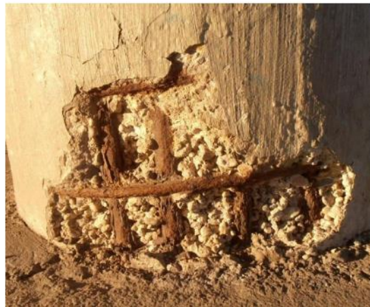
Şekil 6.8: Pasın Betonun Zorlayarak Pullanma Korozyonuna Sebep Olması
