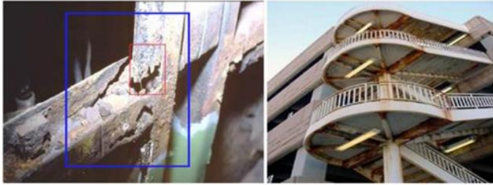
Şekil 6.7: Korozyon Sebebiyle Oluşan Malzeme Kaybı Hasarı ve Paslanmış Çelik
