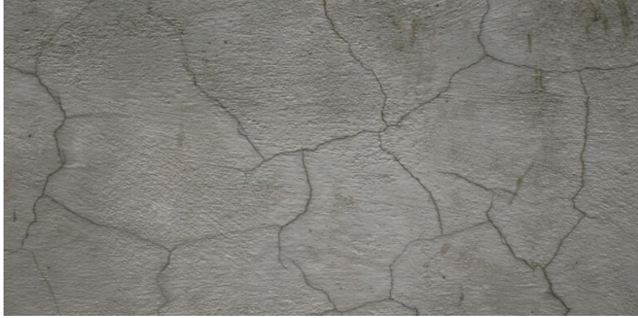
Şekil 4.3: Plastik Rötre Çatlakları
