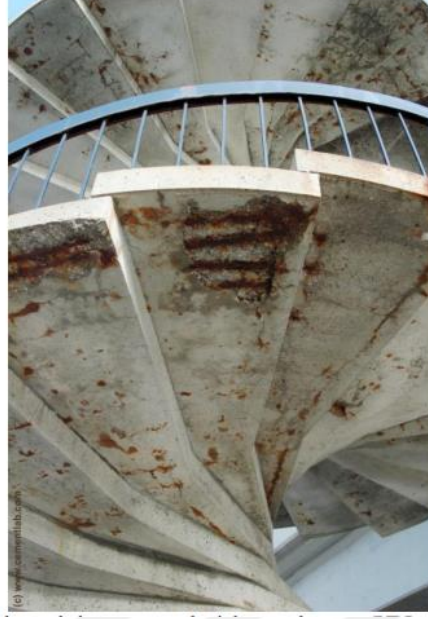
Şekil 6.9: Merdiven Altındaki Betonda Korozyon Nedeniyle Pas Oluşumu
