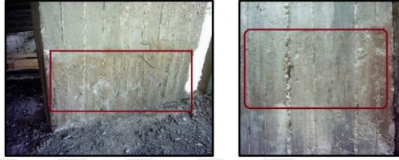
Şekil 6.12: Kolonlarda Meydana Gelen Hasarlar
