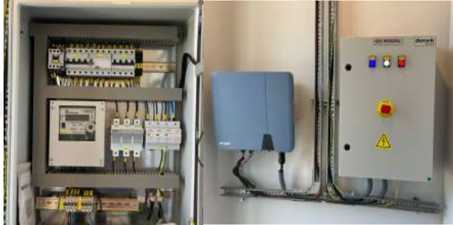
Şekil 4.1: GES Panosu ve İnverter
