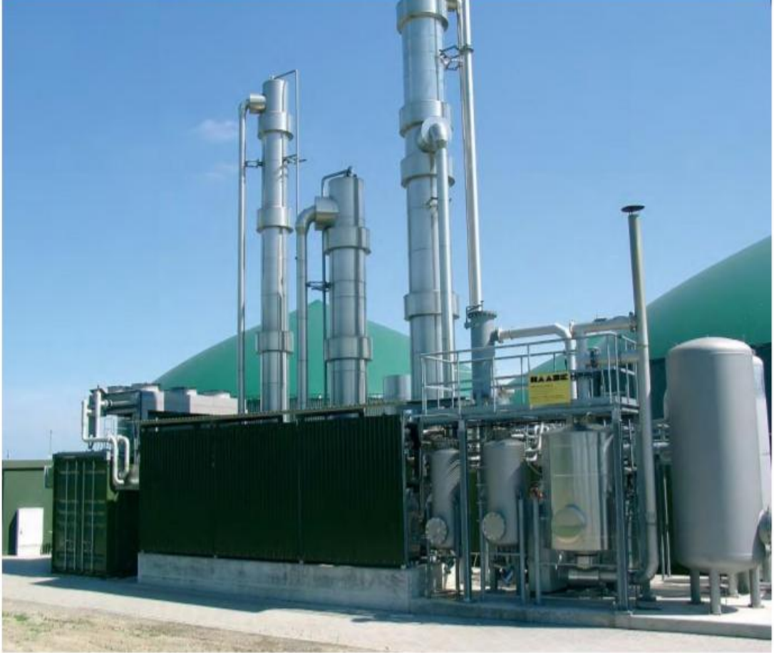
Şekil 3.2 : Polietilenle yıkama ünite
