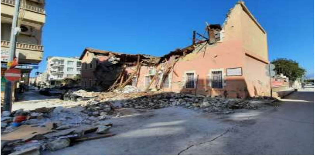
Şekil 21.7: Mithatpaşa Ortaokulu 6 Şubat Depremi Sonrası
