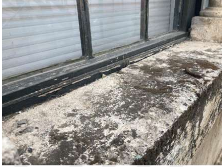
Şekil 4.78: Kuzeydoğu Cephesi Pencere Sövesi Yüzey Bozulması Fotoğrafı
