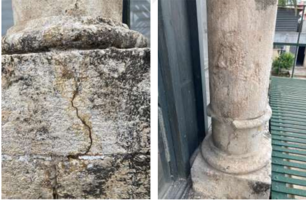
Şekil 4.79: Kuzeydoğu Cephesi Sütun Kaidesi Çatlama ve Derz Boşalması Fotoğrafı
