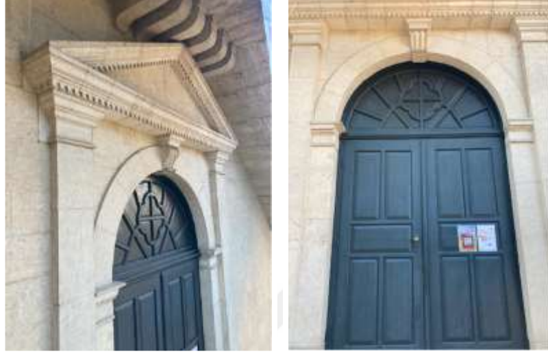
Şekil 4.31: Güneydoğu Cephesi Restorasyon Sonrası Konferans Salonu Giriş Kapısı ve Üçgen Alınlık Fotoğrafi
