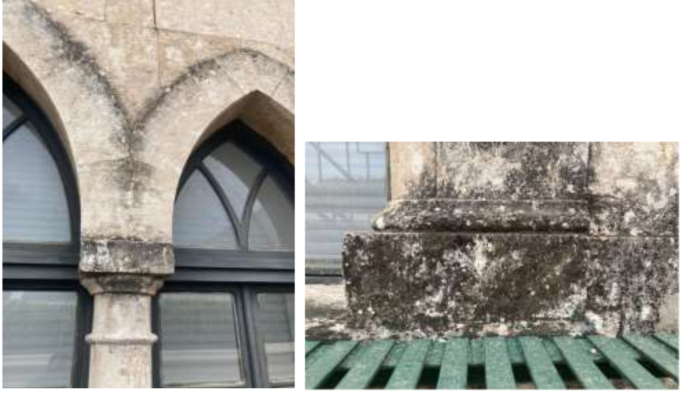
Şekil 4.80: Kuzeydoğu Cephesi Sütun Kaidesi Yüzey Kararması ve Tuz Kristallenmesi Fotoğrafı
