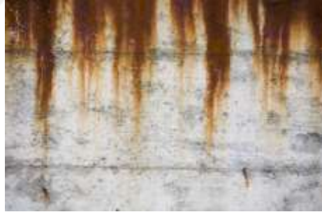
Şekil 4.77: Pas Oluşumu Fotoğrafı
