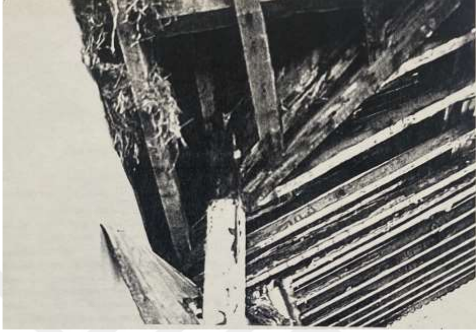
Şekil 4.46: Stickler Hall Çatı Kaplaması Sökümü Sonrası Gözlemlenen Çürüme ve Kırılmaya Uğramış Ahşapların Fotoğrafi
