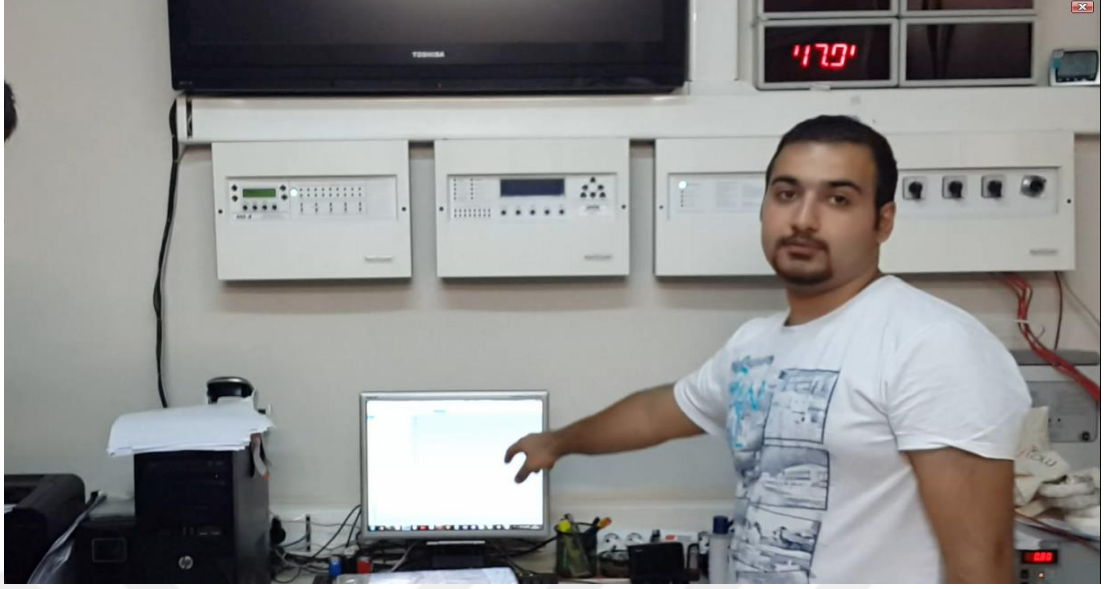
Resim 21- Yangın Test Odası Kontrol Bölümü
