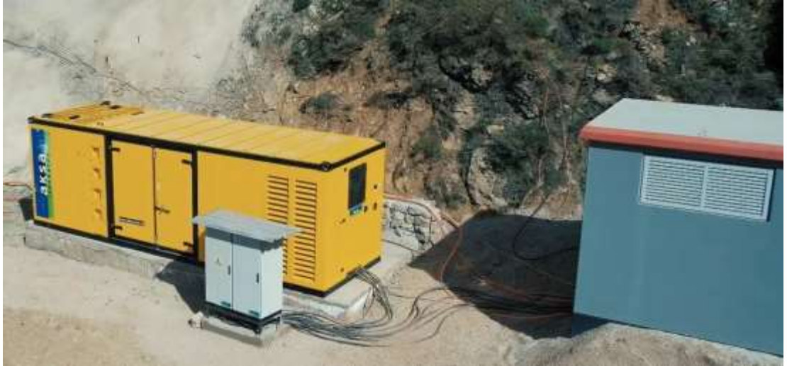
Şekil 6.14: Tehlike Oluşturan Jeneratör Bağlantısı
