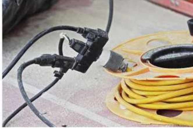
Şekil 6.13: Bakımı Yapılmamış Kablo Örneği
