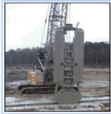
Şekil 2. 20: Vinçe Montelenmiş Kepçe Ağzı
