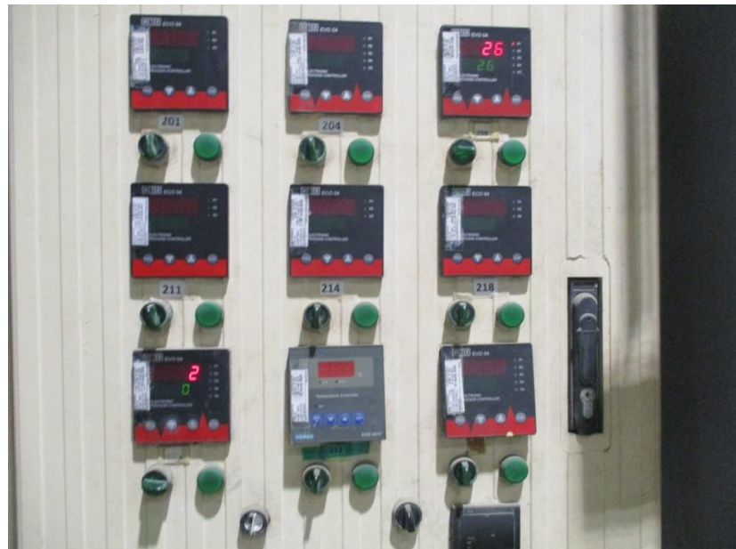
Şekil 3.16: Kimyasal Havuzların Kontrol Paneli
