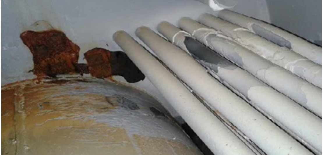
Şekil 5.8: Kalsiyum karbonat birikintisi görünümü
