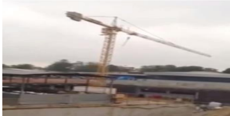
Şekil 27: İstanbul-Yenikapı Metro İnşaatında Meydana Gelen Kule Vinç Kazası ( http://www.yapihaberleri.net/haber/Yenikapı-metro-insaatında-vinc-kazasi.html ).
