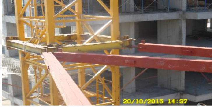
Şekil 20: Kule Vinç Bina Bağlantısı.
