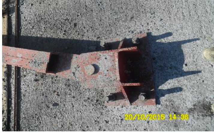
Şekil 19: Kule Vinç Bina Bağlantısı.
