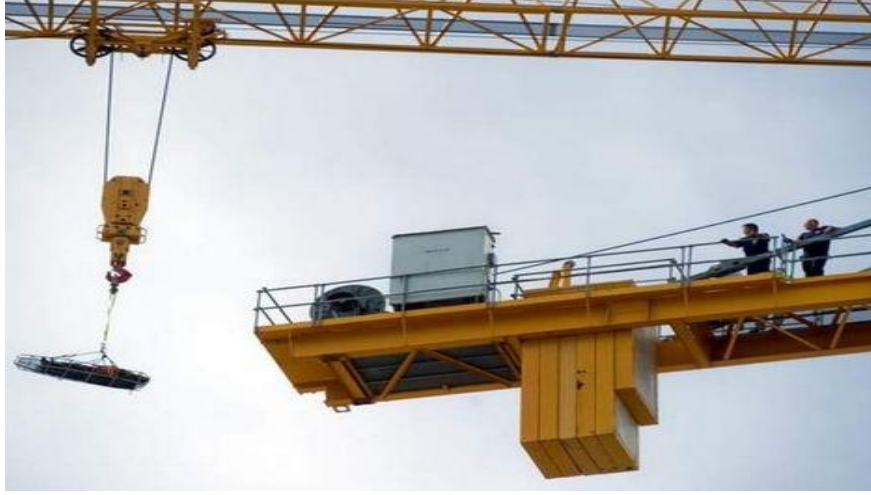
Şekil 33: ABD-Kaliforniya-Stockton'da Meydana Gelen Kule Vinç Kazası ( http://www.craneaccidents.com/2015/10/report/crane-operator-rescued-2/usa-california ).
