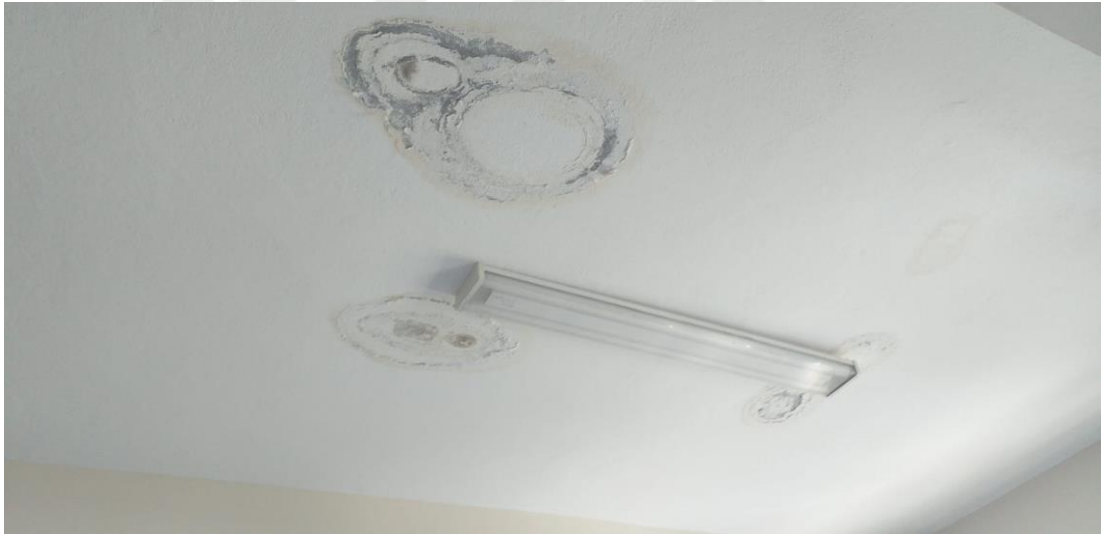
Şekil 3.1: Çatıda Oluşan Su Sızıntısı
