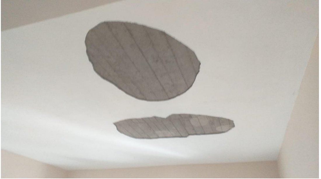
Şekil 3.2: Tavanda Oluşan Sıva Dökülmesi
