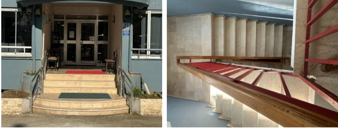
Şekil 5.36: Toplu Konut 1 Sitesinde Solda Giriş Merdiveninde Kaymayı Önleyici Önlem Alınmaması
