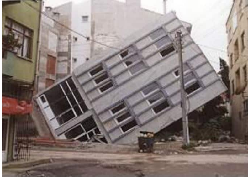
Şekil 2.5: Zemin Sivilaşması ve Yetersiz Temel Boyutlandırması Sonucu Yana Devrilmiş Bir Yapı
