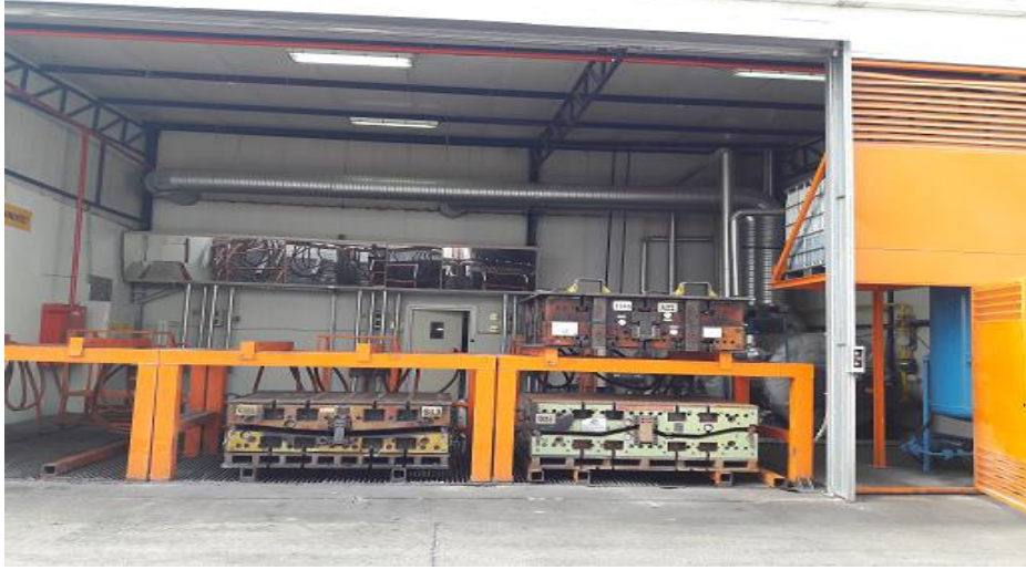
Şekil 5.24: Ön Isıtma İstasyonu
