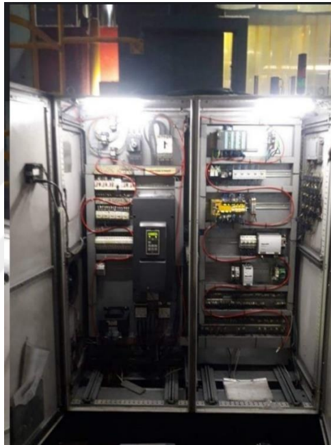
Şekil 5.30: Vaka 6 da Anlatılan İş Kazasının Yaşandığı Elektrik Panosu
