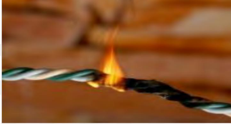
Şekil 5.16: Kabloda Aşırı Akıma Bağlı Isınma ve Tutuşma [19]
