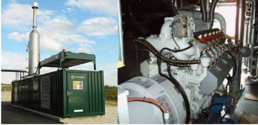
Şekil 4.12: Gaz Motoru ve Kojenerasyon Ünitesi
