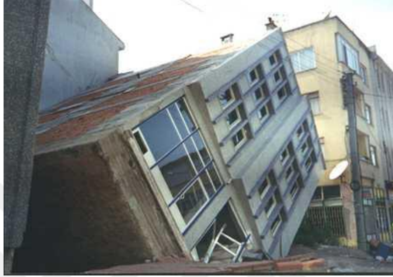
Şekil 2.12: Sıvılaşma kaynaklı oturma hasarı
